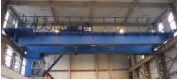
図 3.天井クレーン
