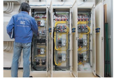
太陽光発電設備の充放電実験：配電盤
