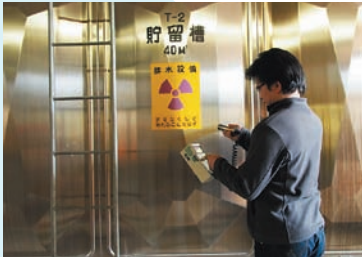
線量率の測定：貯留槽
