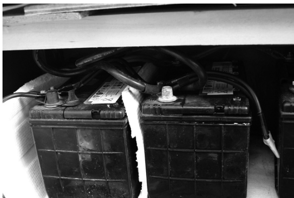
図 2. バッテリーの設置状況
