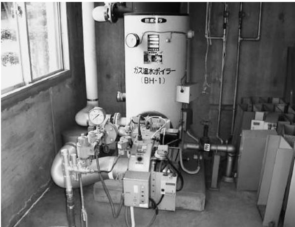
温室用ボイラー
